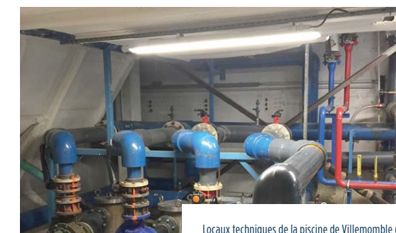
Locaux techniques de la piscine de Villemomble (93)
